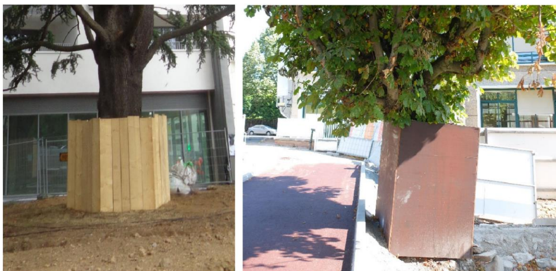
Figure 18 Photographie de coffrages protégeant les parties aériennes des arbres non clôturés (Phytoconseil, 2023)
