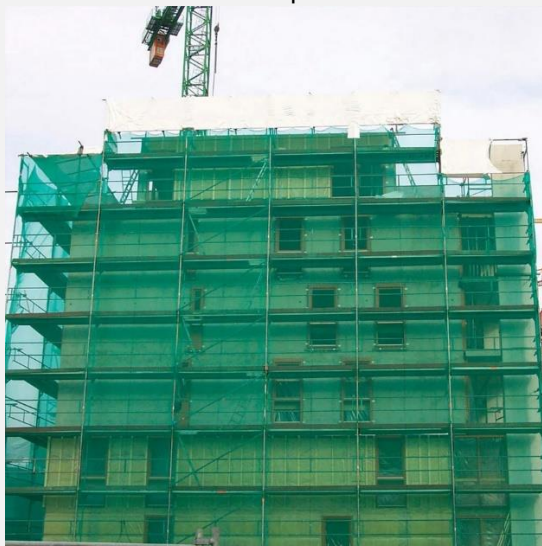
Filet sur échafaudage (source Protecta screen)
