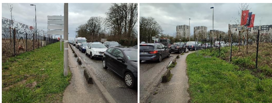
Figure 184 : Ruptures d'aménagements piétons et cyclables Avenue Politzer RD58 vers l'Est (CDVIA, 2024)
