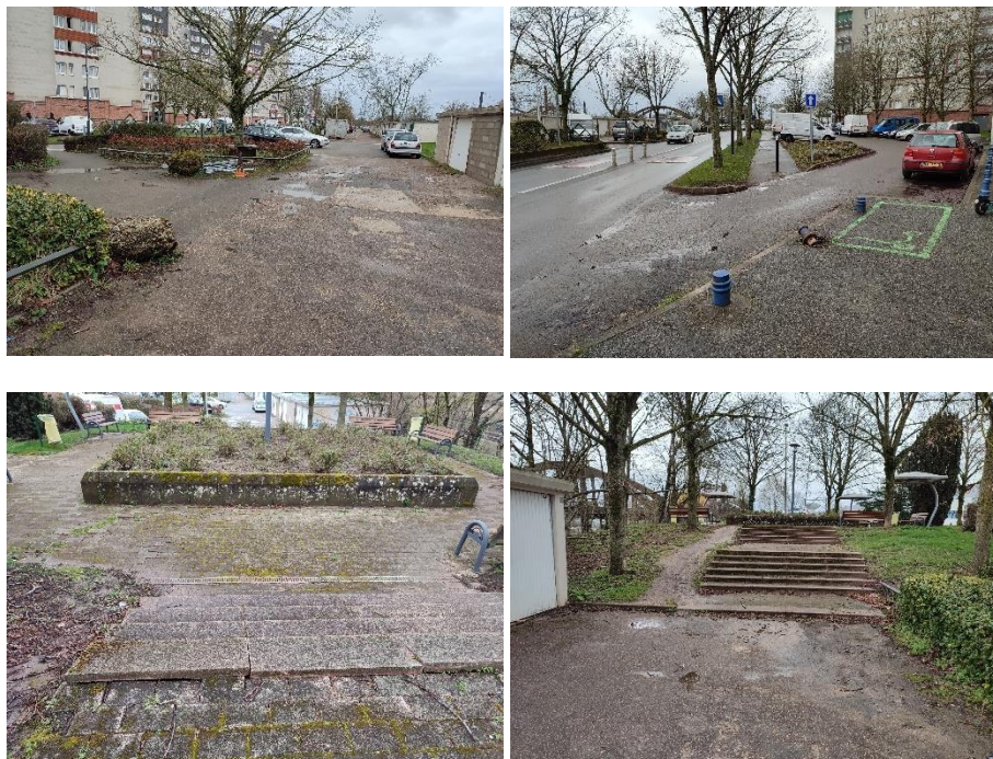
Figure 176 : Aménagements urbains dégradés ou datés à rénover (CDVIA, 2024)
