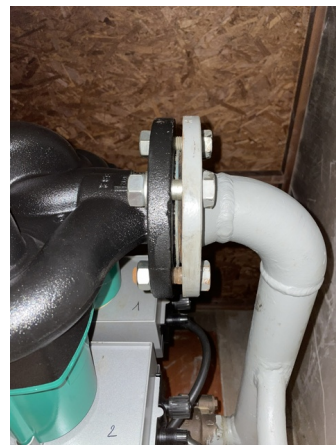
Prélèvement - P36 : RDC / Sous station - Joint de bride- (Présence d'amiante)
