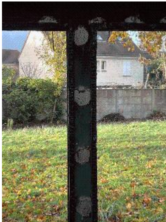
Prélèvement - P93 : RDC / Classe 8 - Plot de colle- (Absence d'amiante)
