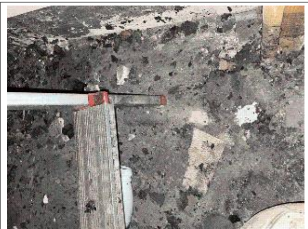
Prélèvement - P38 : RDC / Sous station - Ragréage- (Présence d'amiante)
