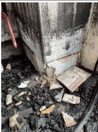
Prélèvement - P51 : RDC / Sanitaires 1 - Colle de plinthe- (Présence d'amiante)
