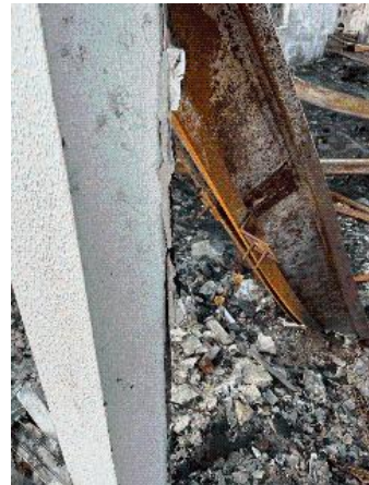
Prélèvement - P66 : RDC / Préau - Joint d'étanchéité entre menuiserie et structure- (Absence d'amiante)
