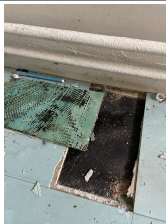
Prélèvement - P9 : RDC / Salle de réunion - Dalle de sol, Colle bitumineuse- (Absence d'amiante)
