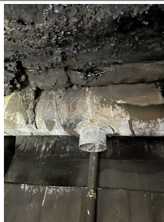
Prélèvement - P52 : RDC / Sanitaires 1 - Mastic- (Présence d'amiante)
