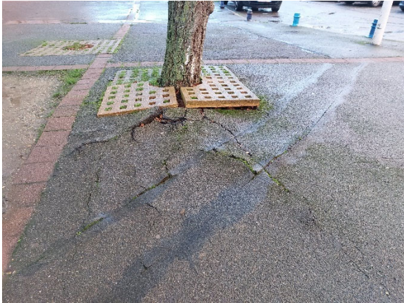
Bouleau n°110 : les racines provoquent des dégâts sur le revêtement du trottoir et soulèvent la grille en béton qui recouvre la fosse
