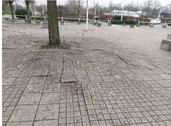
Saule n°339 : les racines soulèvent les dalles du trottoir
