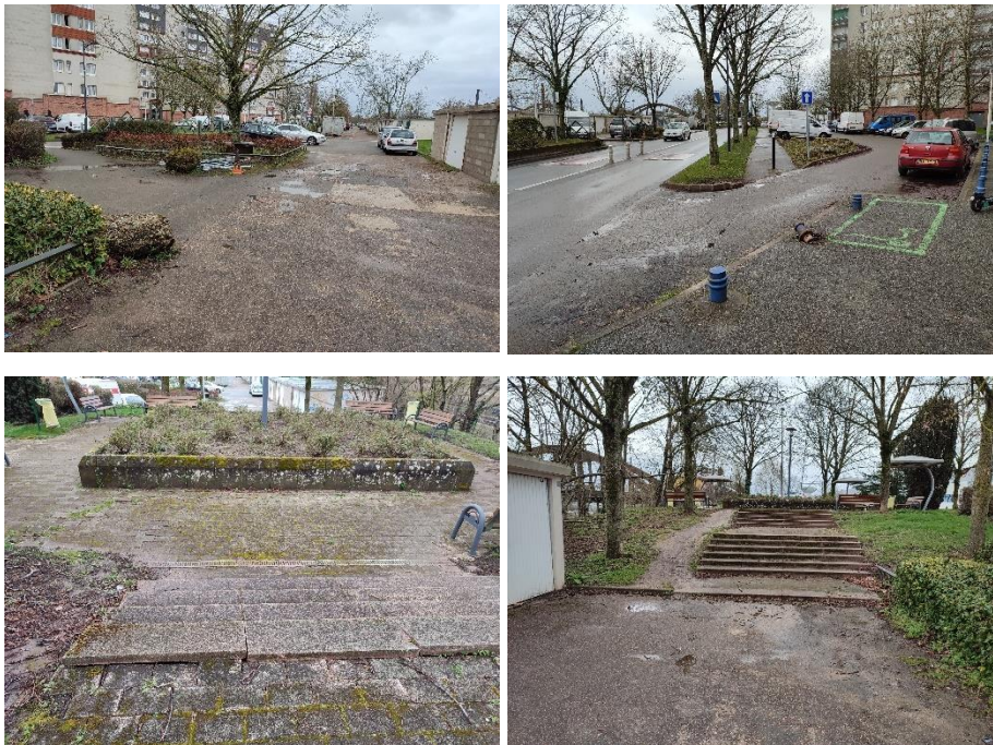
Aménagements urbains dégradés ou datés à réover
