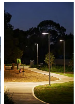
Les mâts permettront d'éclairer les espaces principaux du parc
