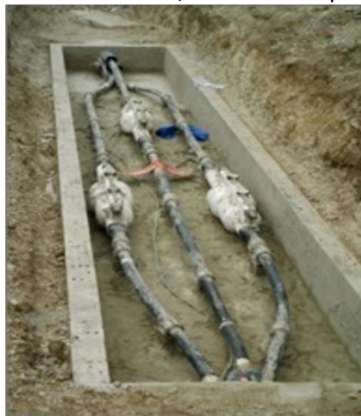
Figure 3: Chambre de jonction
