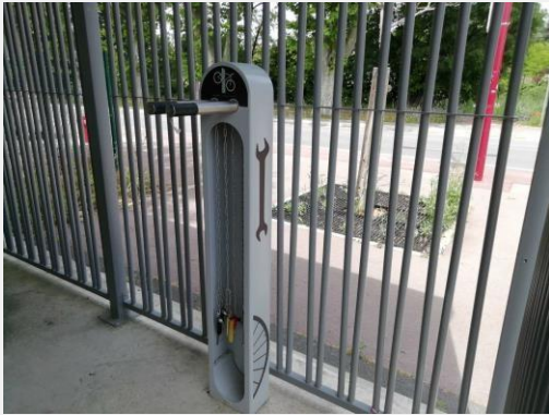
Borne réparation en consigne collective
