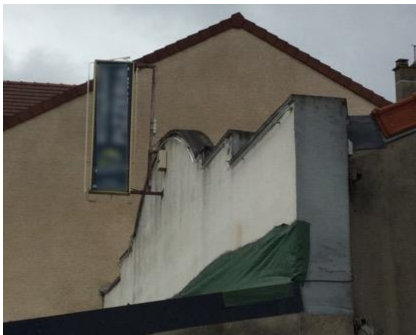
Enseigne perpendiculaire dépassant la limite du mur (non conforme), Les Clayes-sous-Bois, 2017
